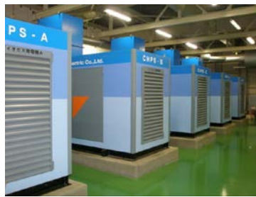
図-14 デュアルフューエル発電機 (80kW×5台)
