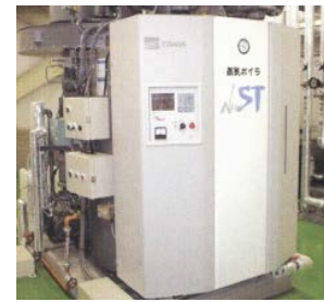
図-15 バイオガス蒸気ボイラ (1,078,000kcal/h×1台)
